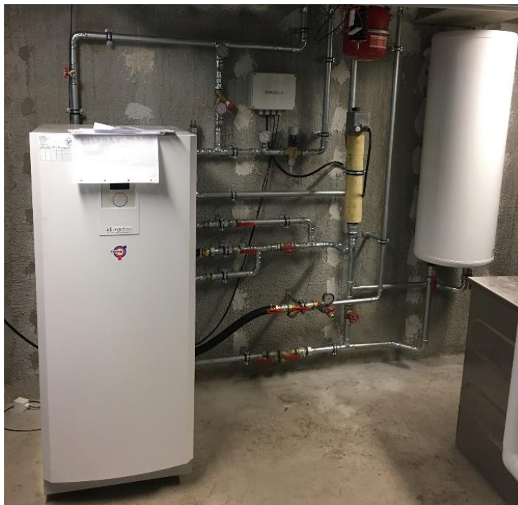
Figur 9: Billede af varmepumpeinstallation i P1/P2
