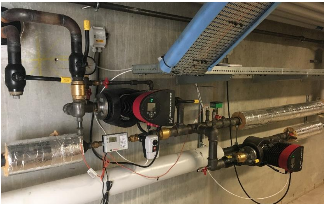
Figur 8: Billede af stikindføring og blandesløjfe med booster- og shuntpumpe.
