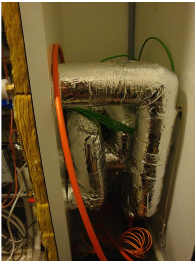
Figur 2 Isoleret rørføring før måler til FVB-units
