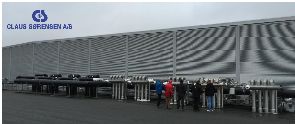
Figur 5-6: Rør til indfrysningstuneller på taget ved Claus Sørensen A/S i Vejle
