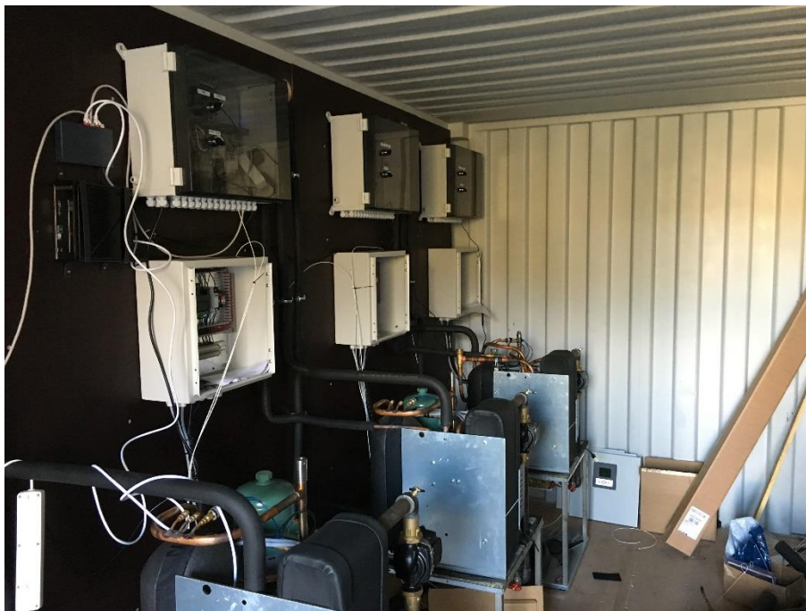
Figur 5-16: Varmepumperne inde i containeren
